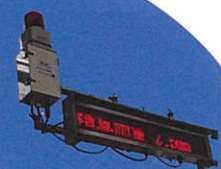
防災灯(電光掲示板・回転灯) による基準値超過の通報
