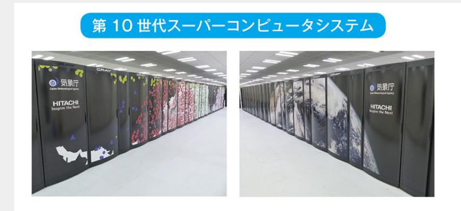
図-2 第10世代スーパーコンピューターシステム 出典：気象庁「気象庁はいま2018」より
