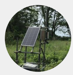
太陽光電源装置
