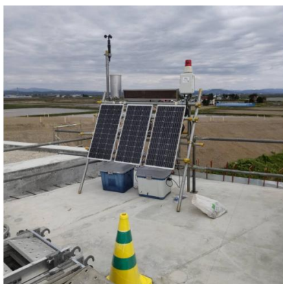
太陽光電源装置
