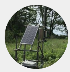
太陽光電源装置
